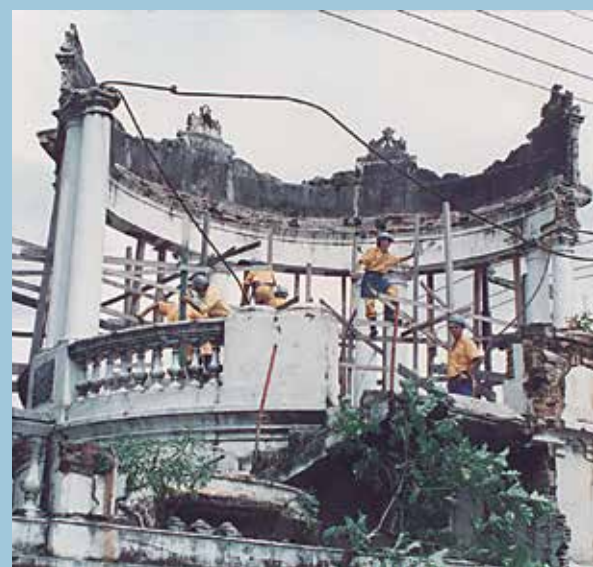
Em 1995, o teto desaba e restauro começa
